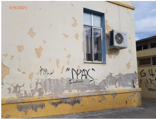
Εικόνα 116. Εξωτερικές φθορές τοιχοποιίας και κονιαμάτων
