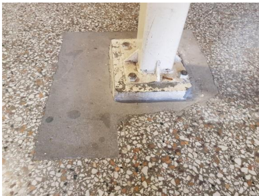
Εικόνα 106. Αλλοίωση μωσαϊκού δαπέδου από την προσθήκη στατικής ενίσχυσης του κτιρίου
