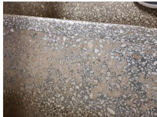
Εικόνα 107. Αλλοίωση μωσαϊκού δαπέδου κλιμακοστασίου
