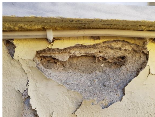
Εικόνα 79. Σκυρόδεμα στην ποδιά του ανοίγματος
