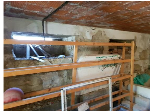
Εικόνα 119. Φθορές κονιαμάτων υπογείου
