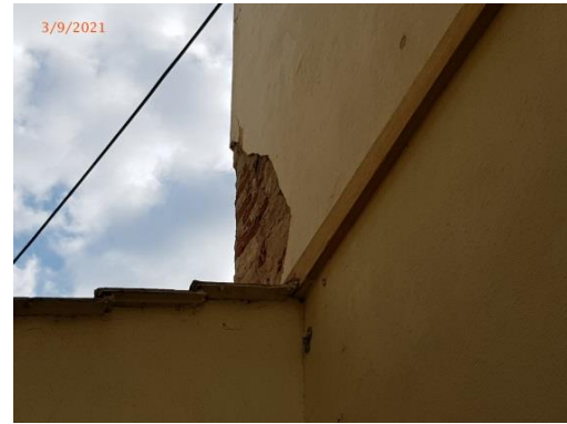
Εικόνα 117. Εξωτερικές φθορές τοιχοποιίας και κονιαμάτων
