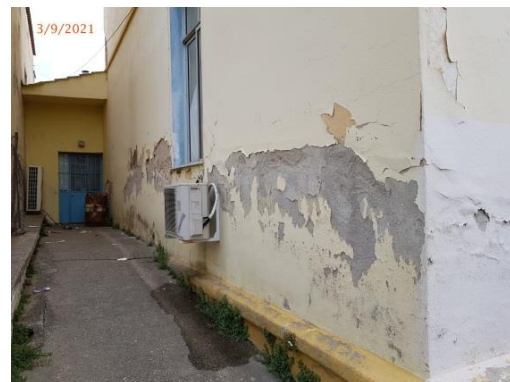
Εικόνες 110-115. Εξωτερικές φθορές τοικοποιίας και
