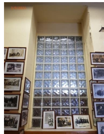
Εικόνες 12 & 13. Παράθυρα ισογείου που έκλεισαν με υαλότουβλο (χώρος I.4)
